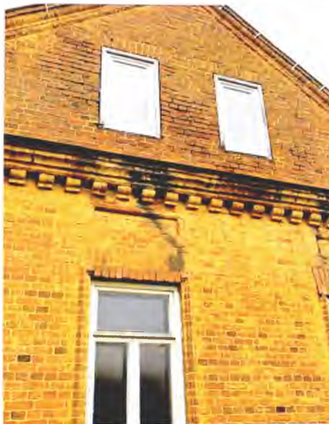
Фото 17. Трещина на северном фасаде. 06.10.2022.
