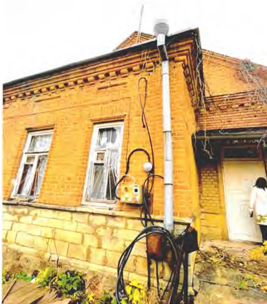
Фото 13. Южный фасад. Утраченные оконные заполнения. Наружные сети. Назаренко Ю.Ю. 06.10.2022.
